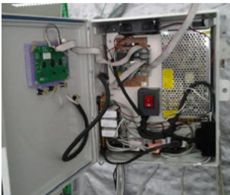
ภาพที่ 6 กล่องวงจรควบคุม
