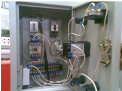
ภาพที่ 7 ชุดควบคุมการทำงาน
